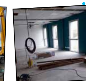
Aménagement des bureaux
